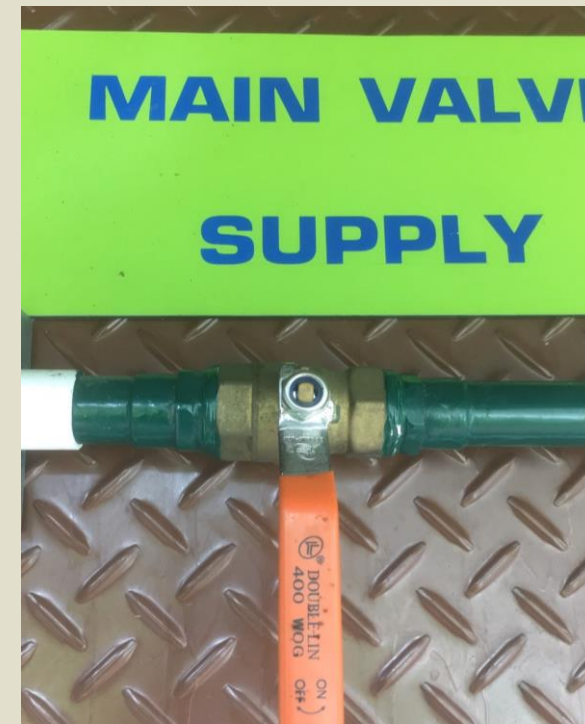
วาล์วจ่ายก๊าซทั้งหมด
