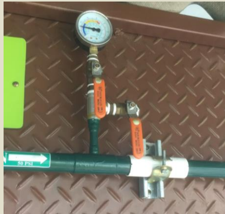
ความดันก๊าซ O 2 เหลือ 50 psi จ่ายให้ผู้ป่วยผ่านระบบ pipeline
