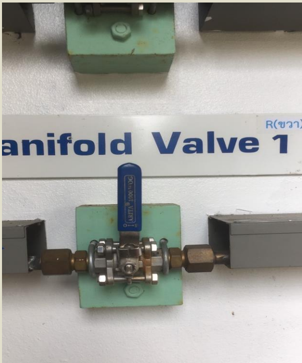
วาล์วจ่ายก๊าซ 1
